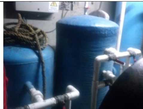
Foto No. 4. Filtros de Arena
