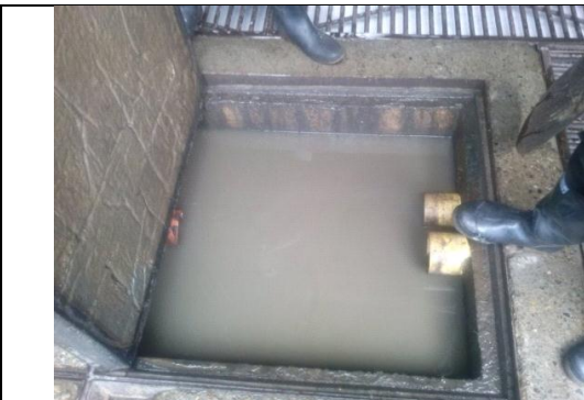
Foto No. 3. Lugar toma de muestra salida del trampa de grasas
